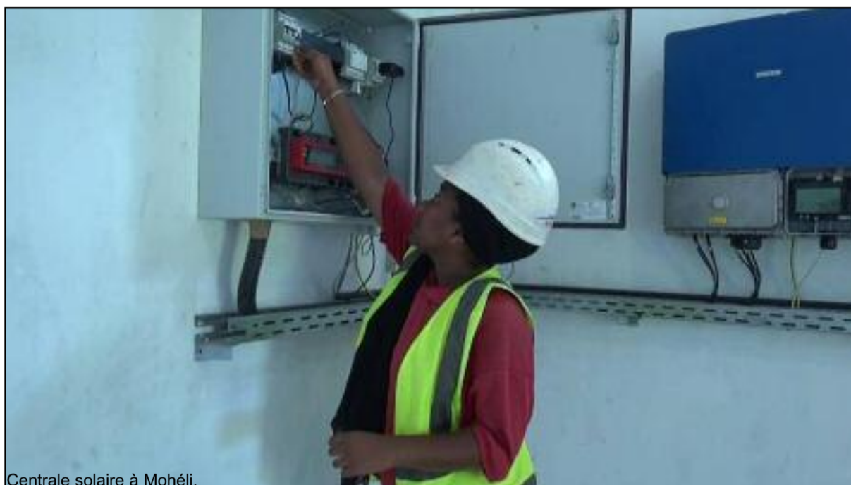
Centrale solaire à Mohéli.
